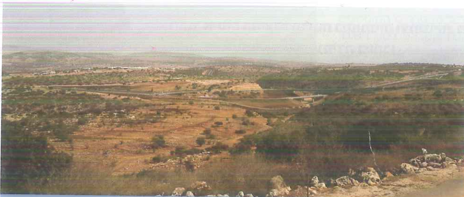
כביש 65 מסד קדרים (בביצוע), תכנון ביצוע: עינב החץ. אדריכלות נוף: גרינשטיין הר-גיל אדריכלות נוף ותכנון סביבתי
